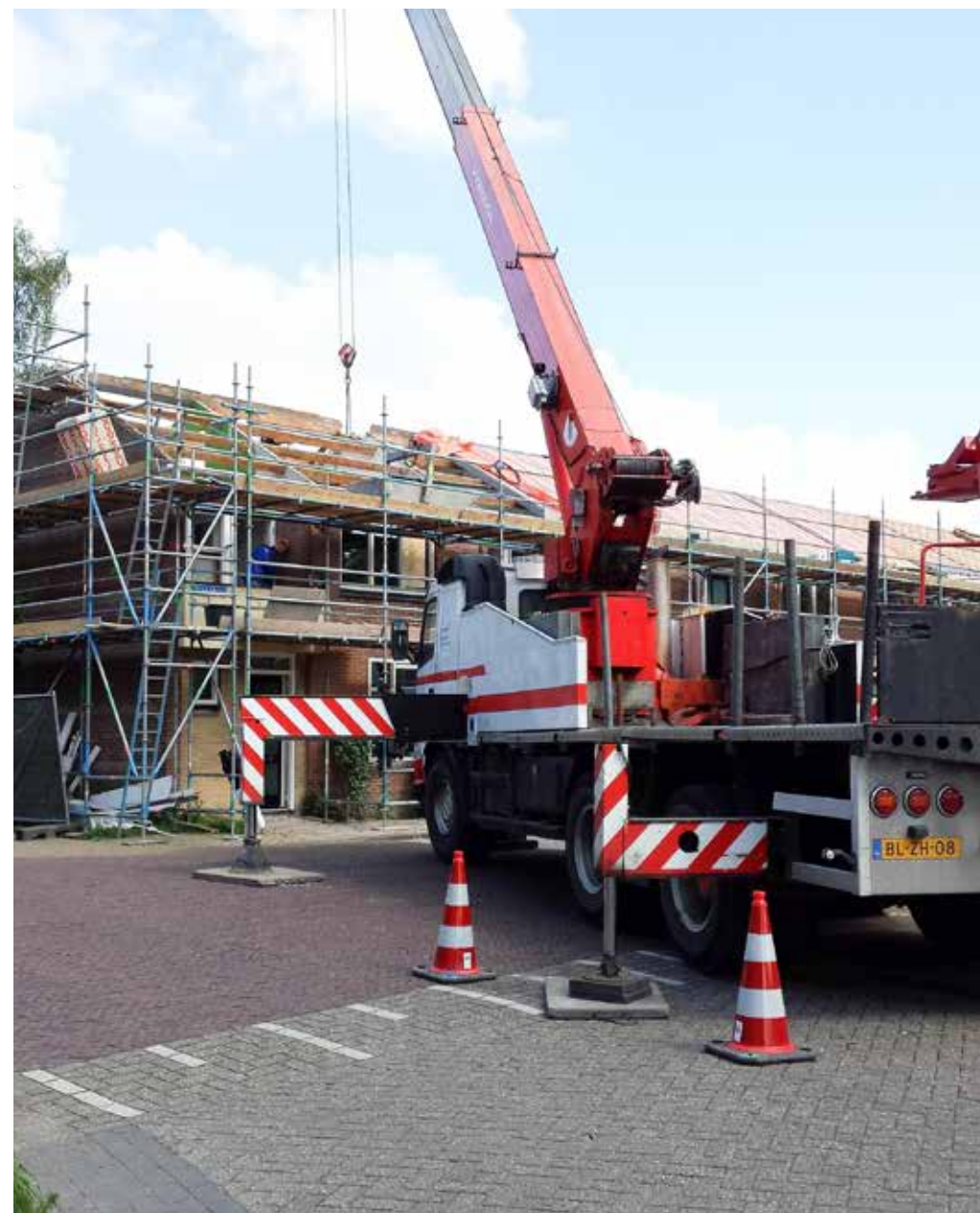
Drie combinaties van bouw- en onderhoudsbedrijven zorgen via resultaatgericht samenwerken voor zowel woningverbetering als planmatig onderhoud van alle 20.000 huurwoningen van woningcorporatie Elkien (foto's: Renée Krijgsman Fotografie)
